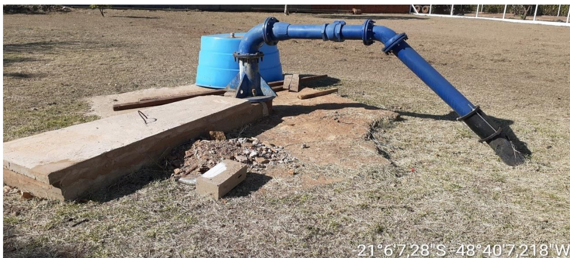
Figura 8-10. Poço 1 – São Pedro
